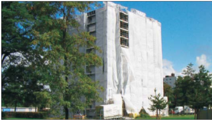
Flachdächer mit unzugänglichen und ungenügend gedämmten Deckenhohlräumen sind bei höheren Gebäuden die Regel
